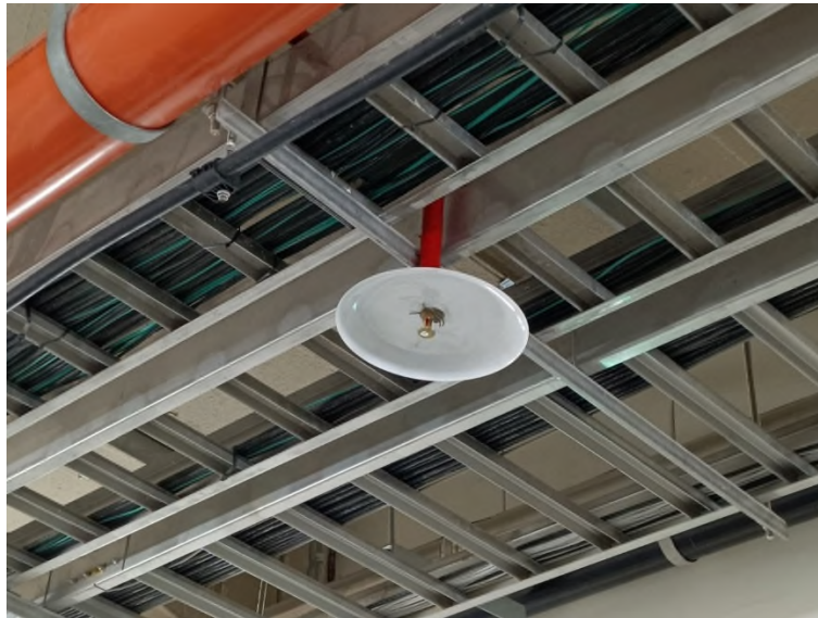
▲圖說：自動灑水滅火裝置&防護板圖(安坑機廠)
