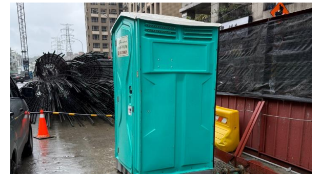
工區臨時廁所
