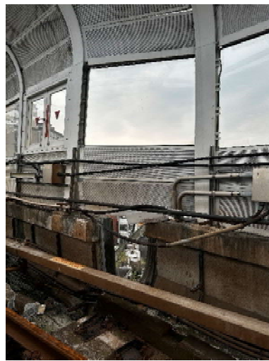
隔音牆變形受損
