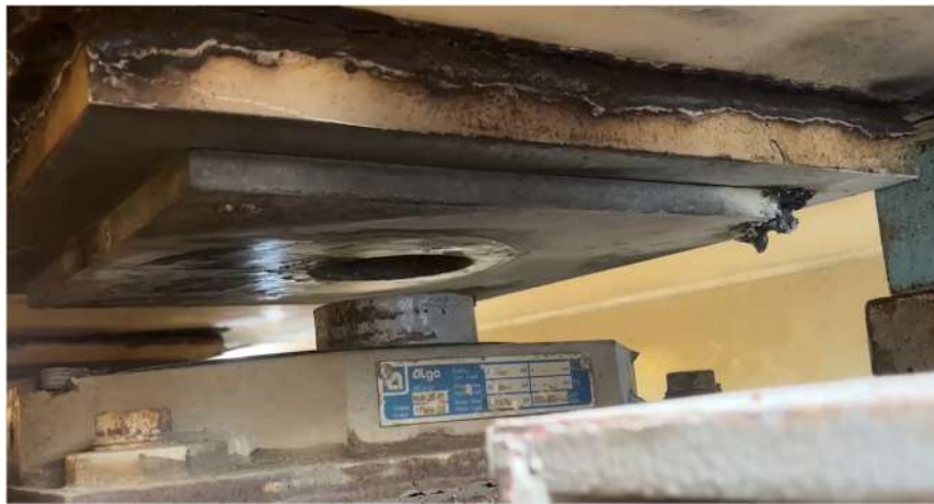
圖 3.3-4 P1216 上、下盤錯位後，鋼箱梁頂升後插銷掉落之照片
