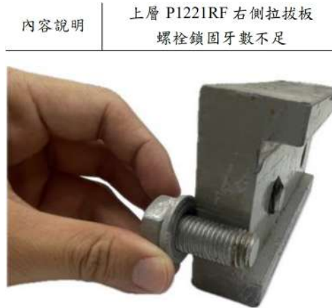
圖 5.4-5 P1221RF 抗拉拔板螺栓鎖固牙數不足之照片
