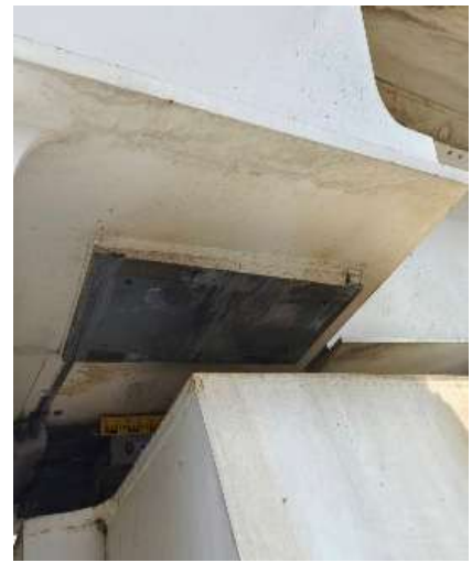
盤式支承損壞
