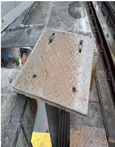
橋護欄偏移破壞
