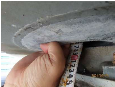
(a) P1217 調坡板及上錨碇板深度 60 mm
