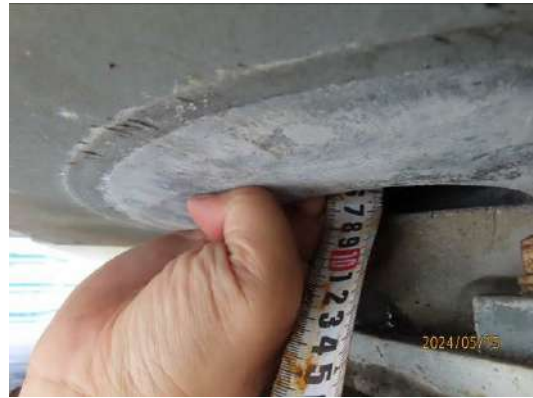
(c) P1217 支承調坡板及上錨碇板深度 60 mm
