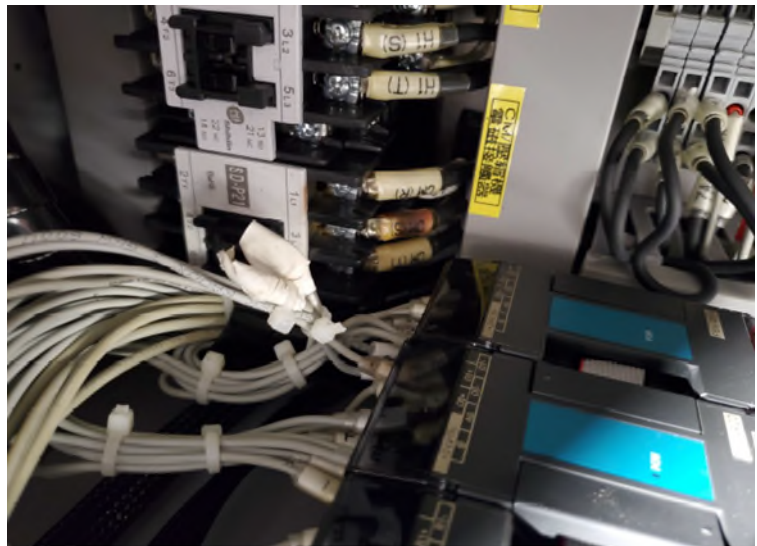
圖 8、壓縮機接觸器
