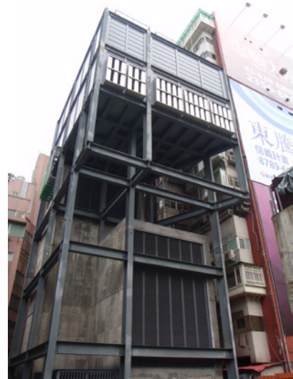
圖7 捷運通風井及冷卻水塔
