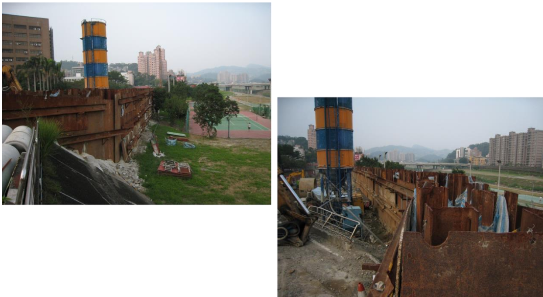
圖 7.3-61 雙層鋼版樁內灌混凝土牆之臨時防洪牆及破堤案例照片
