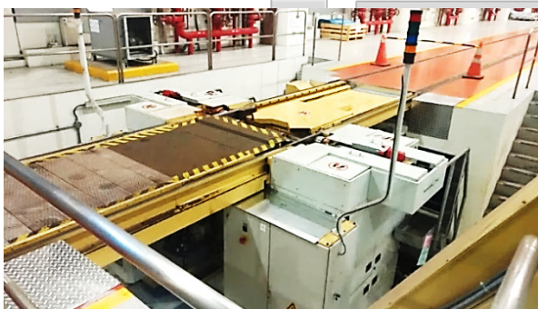
圖 6 地下式自動車輪車床設備
